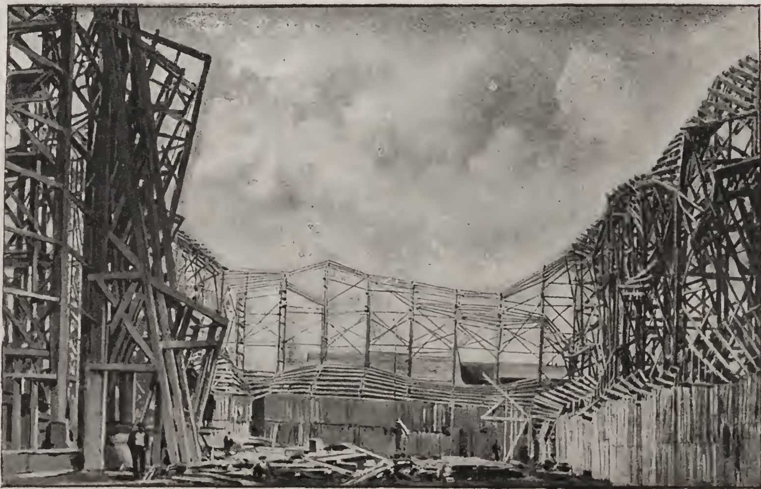
LE VILLAGE SUISSE A L'EXPOSITION DE 1900. — Construction en charpente de la carcasse des montages.
